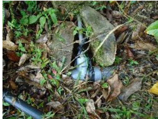
Fotografía 38. Acometida sin protección
