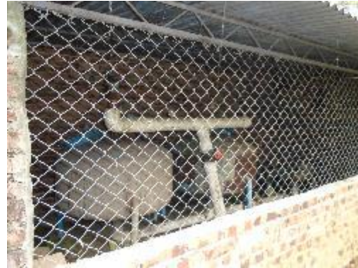
Fotografía 32. Estación de Filtrado
