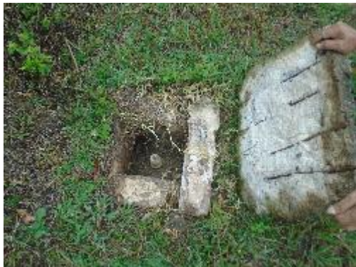
Fotografía 15. Vista Superior Válvula de Aire
