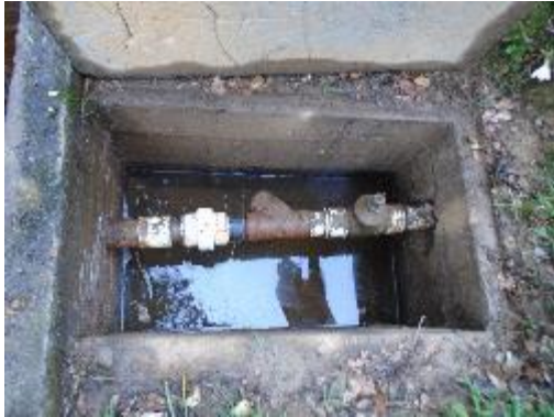
Fotografía 21. Vista Superior caja de válvulas Cámara de Quiebre
