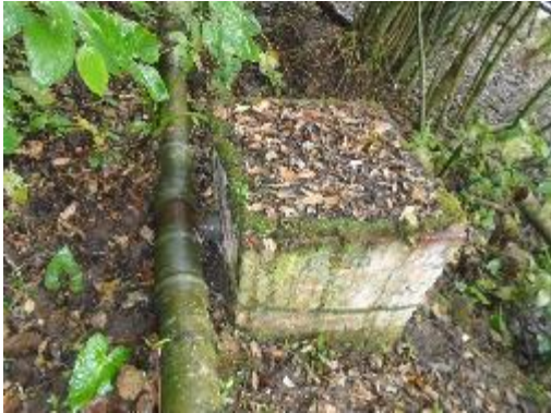
Fotografía 17. Vista Lateral caja Válvula de Purga
