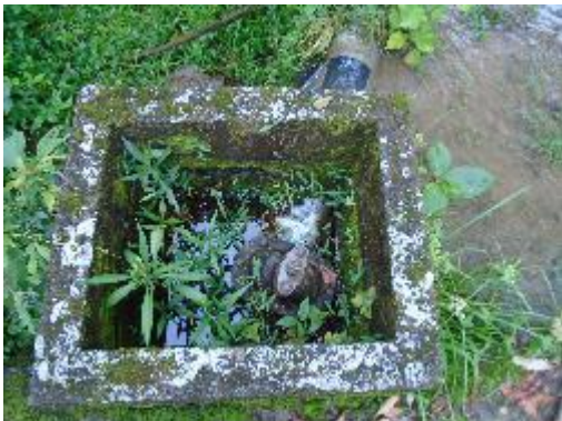
Fotografía 19. Vista Superior Válvula de Purga
