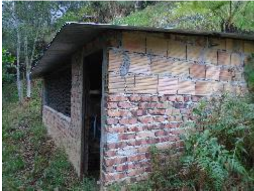
Fotografía 25. Estructura de protección de la Estación de Filtrado
