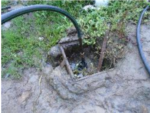
Fotografía 35. Acometida con protección deficiente
