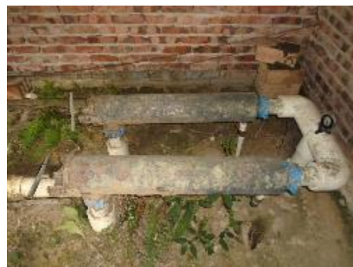
Fotografía 30. Estación de Filtrado
