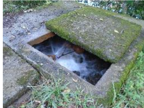
Fotografía 22. Vista Superior caja húmeda Cámara de Quiebre
