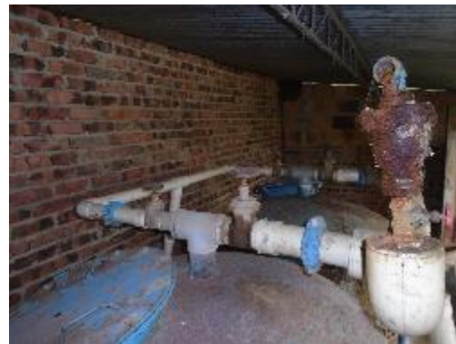
Fotografía 28. Estación de Filtrado
