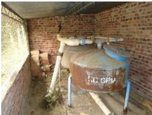
Fotografía 27. Estación de Filtrado
