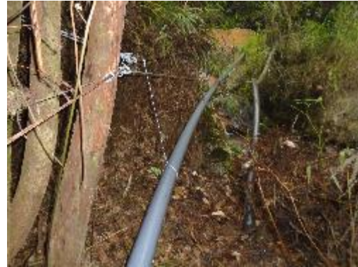
Fotografía 6. Se evidencia tubería descubierta y sostenida con guaya
