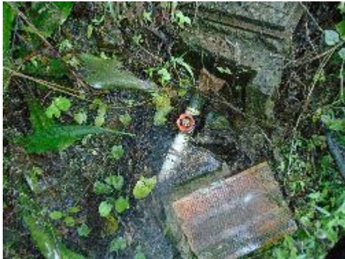
Fotografía 37. Acometida con protección deficiente
