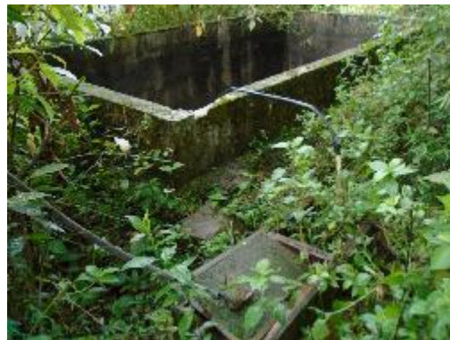
Fotografía 40. Acometida protegida y tanque reservorio
