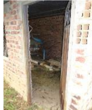
Fotografía 26. Estructura de protección de la Estación de Filtrado
