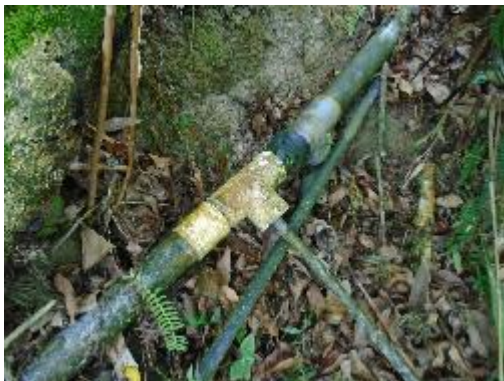
Fotografía 39. Acometida sin protección
