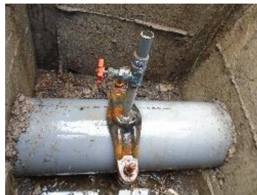
Fotografía 41. Hidrante para los Bomberos
