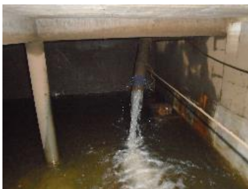
Fotografía 50. Cámara de perdida de Presión C.Q.
