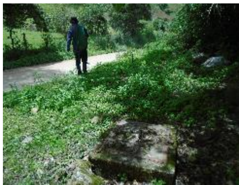
Fotografía 34. Válvula de Aire
