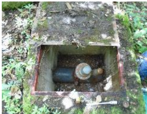
Fotografía 32. Válvula de Aire
