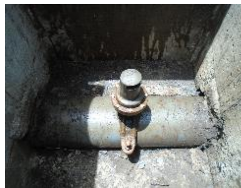
Fotografía 29. Válvula de Aire
