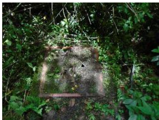
Fotografía 44. Válvula de Purga
