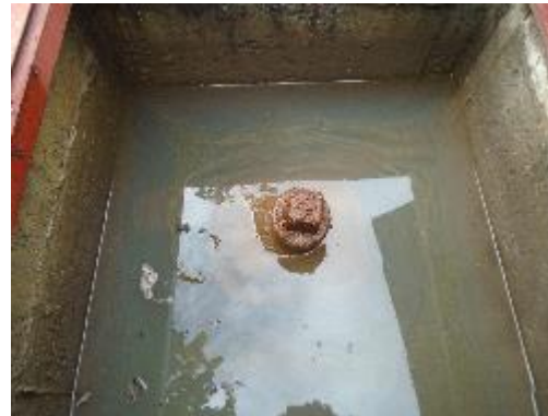
Fotografía 67. Válvula de Corte No 1
