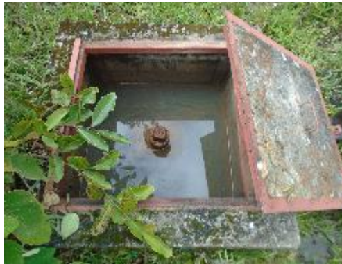
Fotografía 66. Válvula de Corte No 1
