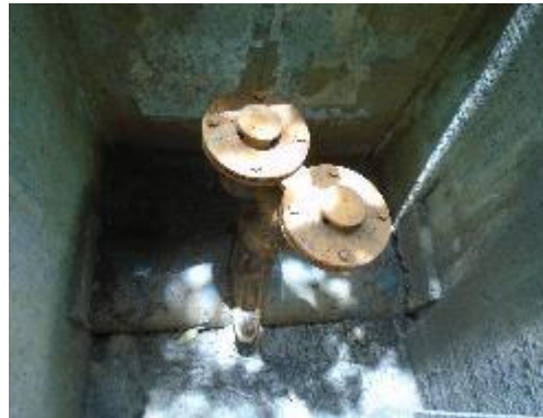
Fotografía 36. Válvula de Aire
