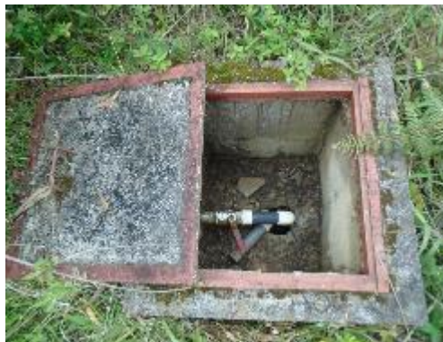
Fotografía 68. Válvula de Corte Para Ramal
