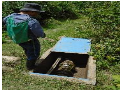
Fotografía 24. Cámara del Macro Medidor
