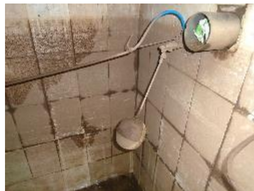
Fotografía 49. Sistema de Control Nivel C. Q.
