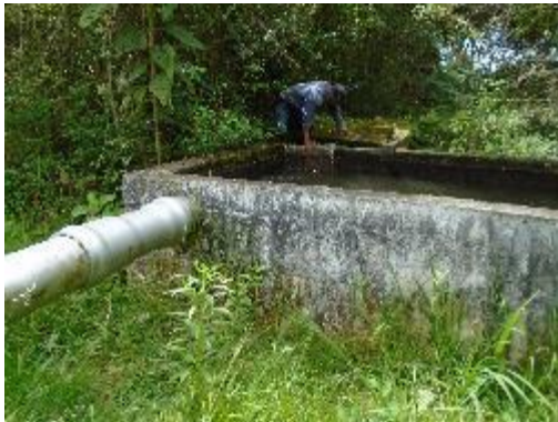
Fotografía 11. Tanque de Recolección
