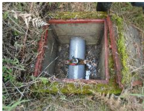
Fotografía 40. Hidrante para los Bomberos
