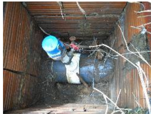
Fotografía 39. Válvula de Aire
