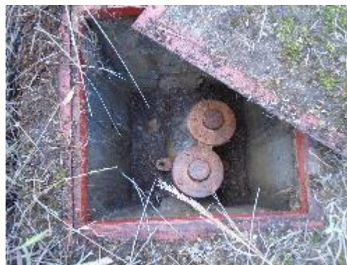
Fotografía 42. Válvula de Aire
