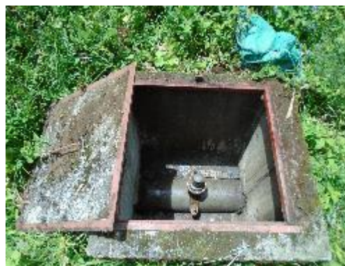
Fotografía 28. Válvula de Aire
