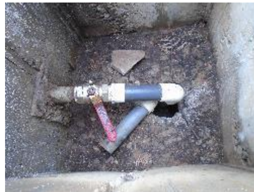
Fotografía 69. Válvula de Corte Para Ramal
