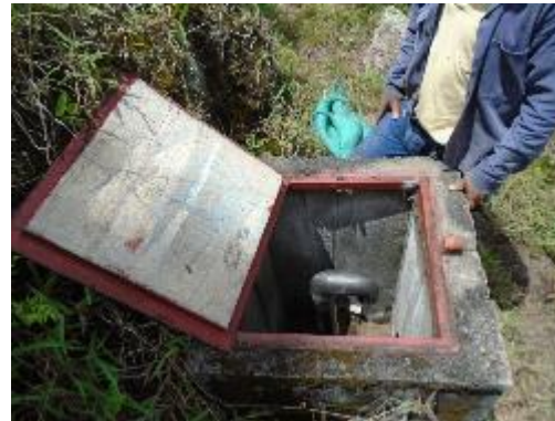
Fotografía 37. Válvula de Aire No 7
