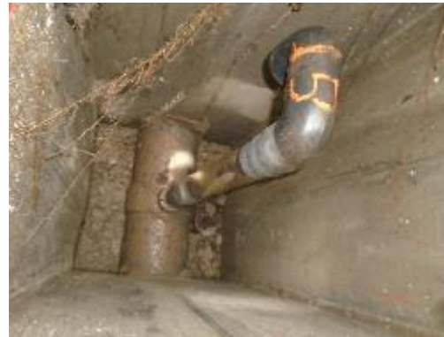
Fotografía 31. Válvula de Aire
