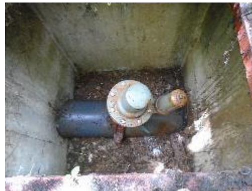
Fotografía 33. Válvula de Aire
