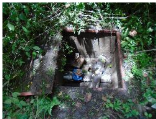
Fotografía 45. Válvula de Purga
