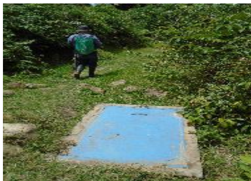
Fotografía 23. Cámara del Macro Medidor
