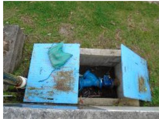
Fotografía 47. Cámara de la Valvuleria C. Q.
