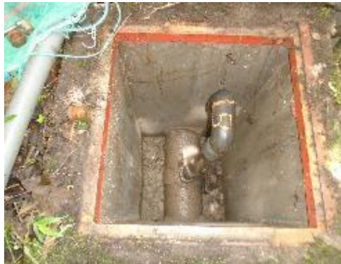
Fotografía 30. Válvula de Aire
