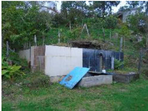
Fotografía 46. Cámara de Quiebre
