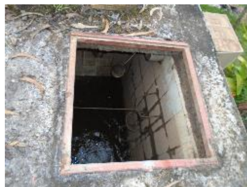
Fotografía 51. Cámara de perdida de Presión C.Q.
