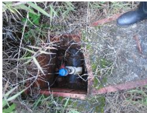
Fotografía 38. Válvula de Aire
