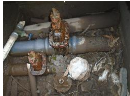
Fotografía 53. Válvulas de Corte para los Ramales
