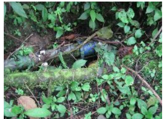
Fotografía 6. Tubería de Conducción a Nivel Suelo
