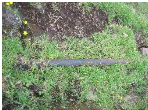
Fotografía 7. Tubería de Conducción a Nivel Suelo
