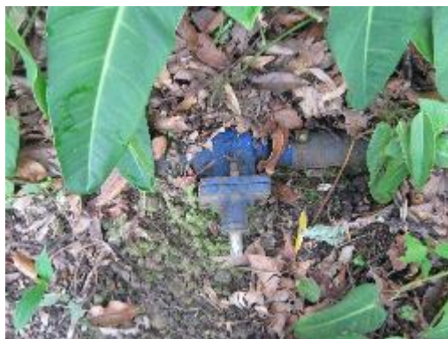
Fotografía 15. Válvula de corte 2”
