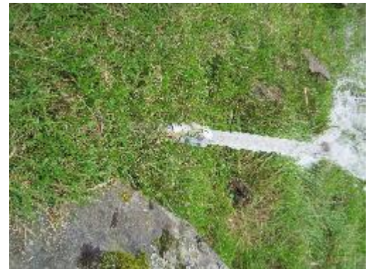
Fotografía 14. Válvula de Purga 2”
