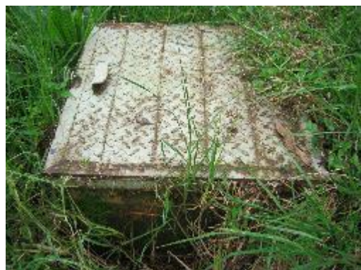
Fotografía 16. Válvula de Corte 2”
