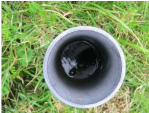
Fotografía 13. Válvula de aire
