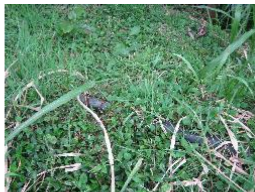
Fotografía 8. Tubería de Conducción a Nivel Suelo
