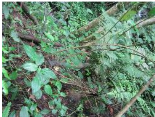
Fotografía 5. Tubería de Conducción a Nivel Suelo
