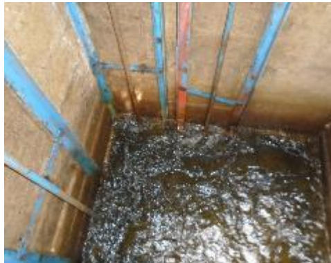
Fotografía 7. Cámara de Recolección
