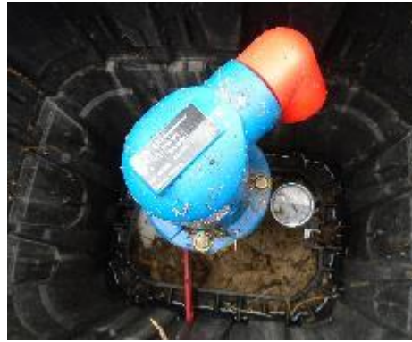
Fotografía 61. Válvula de Aire No 1
