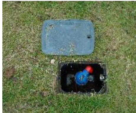
Fotografía 59. Válvula de Aire No 1
