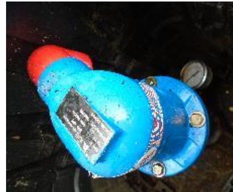
Fotografía 60. Válvula de Aire No 2
