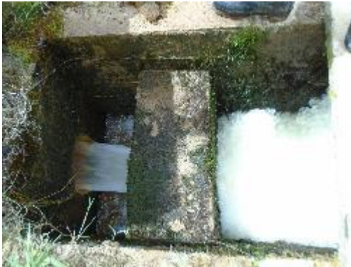
Fotografía 34. Cámara de perdida de Presión C.Q.1
