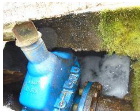
Fotografía 23. Válvula de Entrada Desarenador 2
