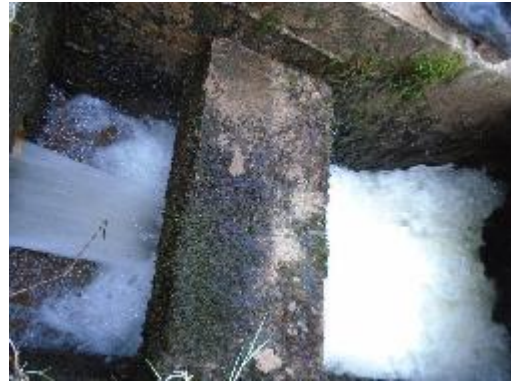
Fotografía 35. Cámara de perdida de Presión C.Q.1
