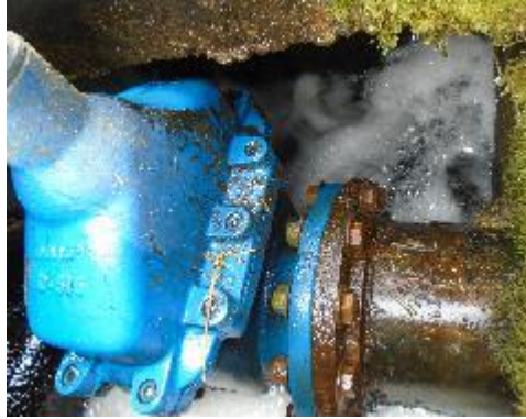
Fotografía 24. Válvula de Entrada Desarenador 2
