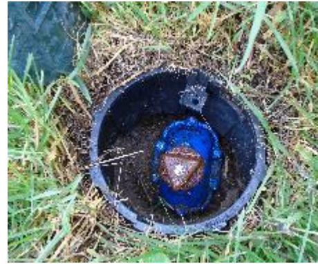
Fotografía 62. Válvula de Corte
