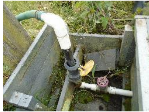
Fotografía 66. Hidrante de Bayoneta y registro
