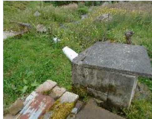
Fotografía 27. Cámara de Lavado Desarenador 2
