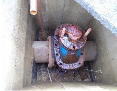
Fotografía 25. Válvula de Entrada Dañada Desarenador 2
