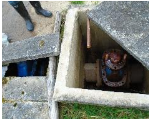
Fotografía 26. Válvula de Entrada Dañada Desarenador 2
