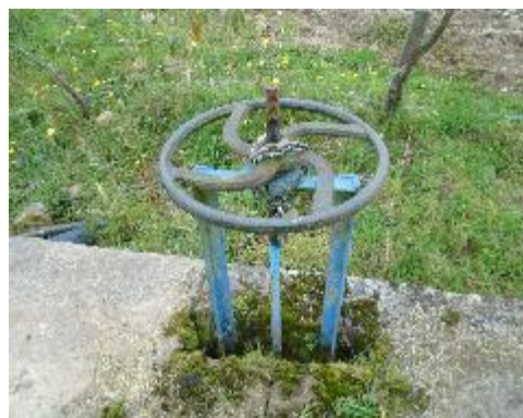
Fotografía 22. Válvula de Lavado Desarenador 2
