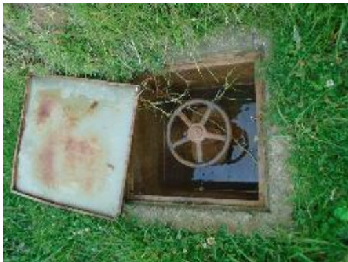
Fotografía 15. Válvula de corte 1
