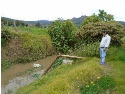
Fotografía 1. Succión de Bombeo
