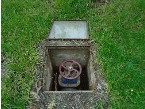
Fotografía 17. Válvula de corte 3
