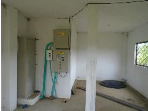
Fotografía 5. Tablero de Control
