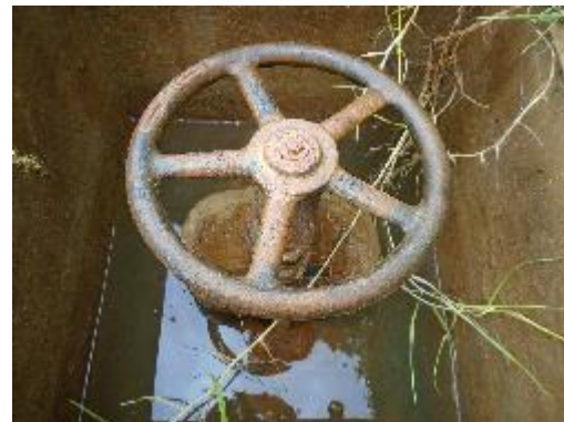
Fotografía 16. Válvula de corte 1
