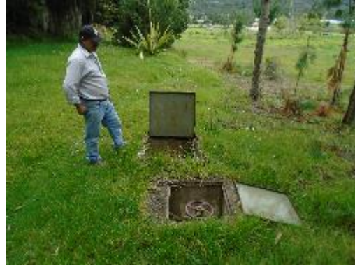
Fotografía 18. Válvula de corte 3
