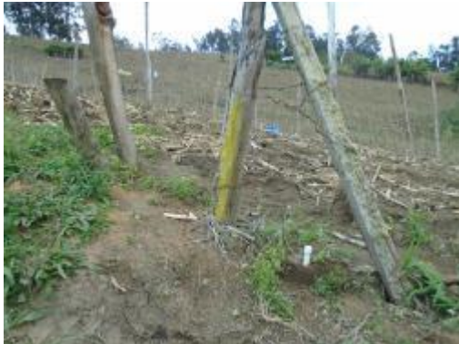
Fotografía 39 Válvula de Aire
