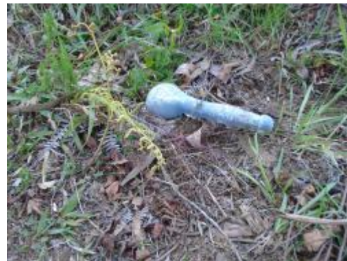
Fotografía 42 Válvula de Corte
