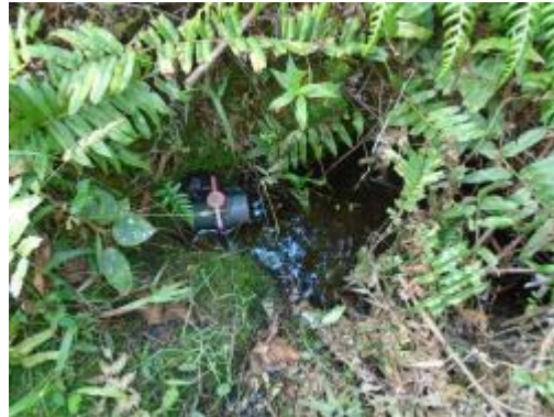
Fotografía 46 Válvula de Purga
