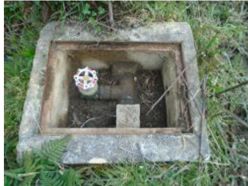
Fotografía 44 Válvula de Corte
