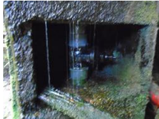
Fotografía 20 Válvula de salida Desarenador
