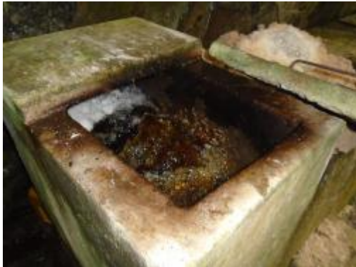
Fotografía 13 Cámara de entrada Desarenador
