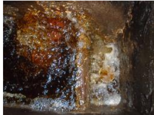
Fotografía 14 Cámara de entrada y Rebose Desarenador
