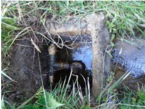
Fotografía 45 Válvula de Purga
