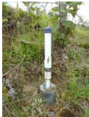
Fotografía 41 Válvula de Aire
