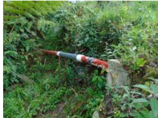
Fotografía 30 Primer Paso Elevado (Fin) y Collarín para Purga
