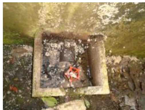
Fotografía 16 Valvulas de Lavado Desarenador
