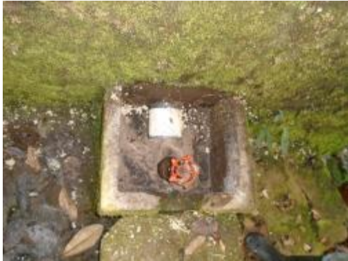
Fotografía 17 Valvulas de Lavado Desarenador
