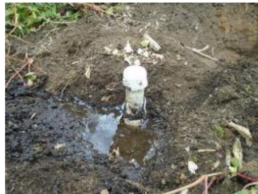
Fotografía 36 Válvula de Aire
