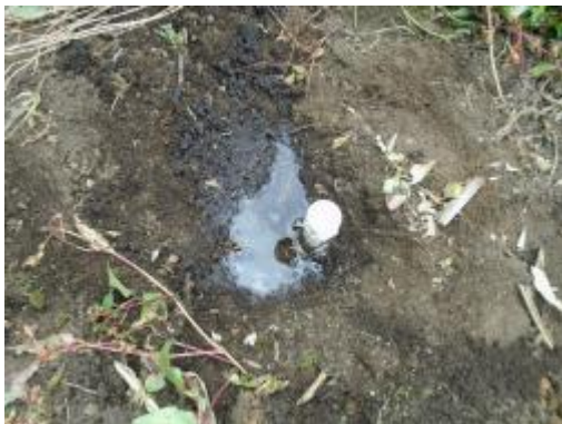
Fotografía 35 Válvula de Aire
