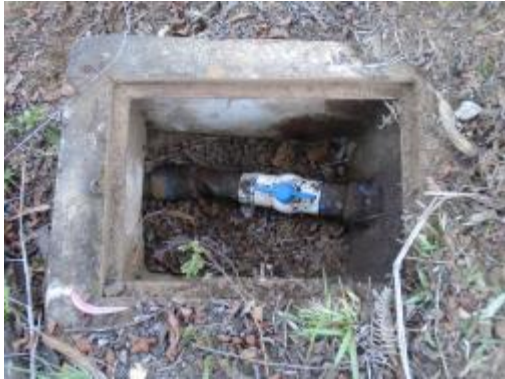
Fotografía 43 Válvula de Corte
