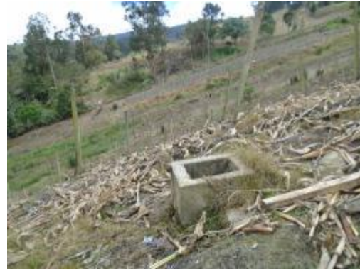
Fotografía 38 Válvula de Aire (caja de protección)
